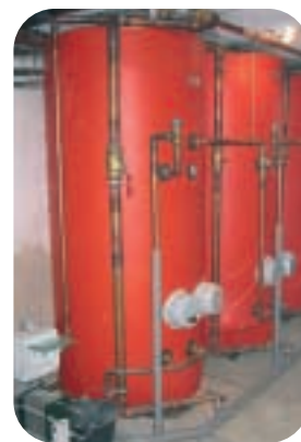
Ballons de stockage de l'eau chaude sanitaire et échangeur de chaleur
