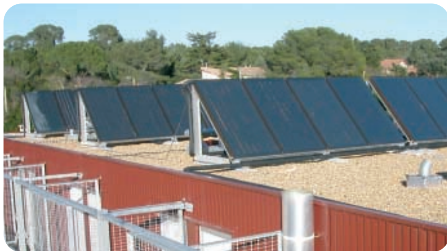
Capteurs solaires pour l'eau chaude sanitaire
