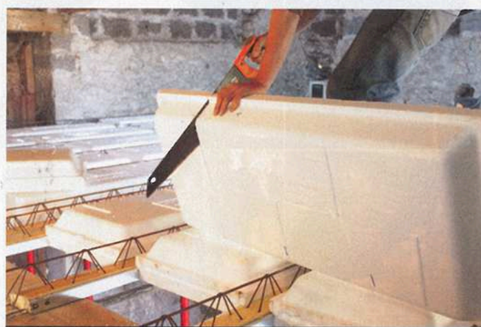
4 La découpe des entrevous se fait facilement à la scie égoïne pour réaliser la finition du coffrage de plancher sur les extrémités.
