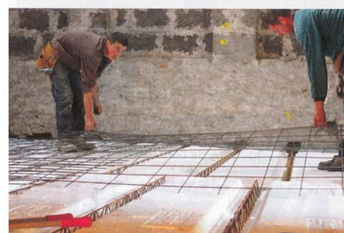
7 Les maçons posent le treillis soudé sur les entrevous en veillant au recouvrement des éléments. Les treillis empêchent la micro-fissuration.
